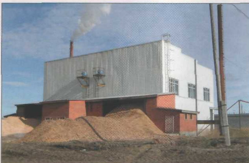
Склад топливной щепы на котельной станции
